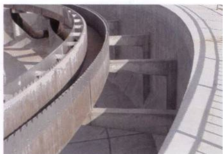
图43-19 刮泥桥出水系统
