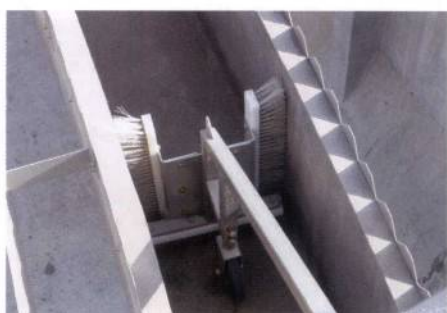
图43-18 刮泥桥毛刷清洁系统
