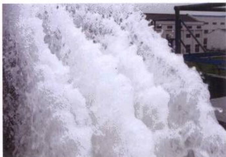
图43-48 Φ1500放射状转碟曝气机运行状况（已成功应用于河南安阳污水处理厂、汝州污水处理厂）
